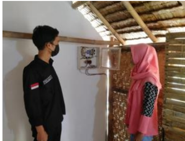
Gambar 7. Tim menjelaskan cara kerja panel kontrol kepada mitra
