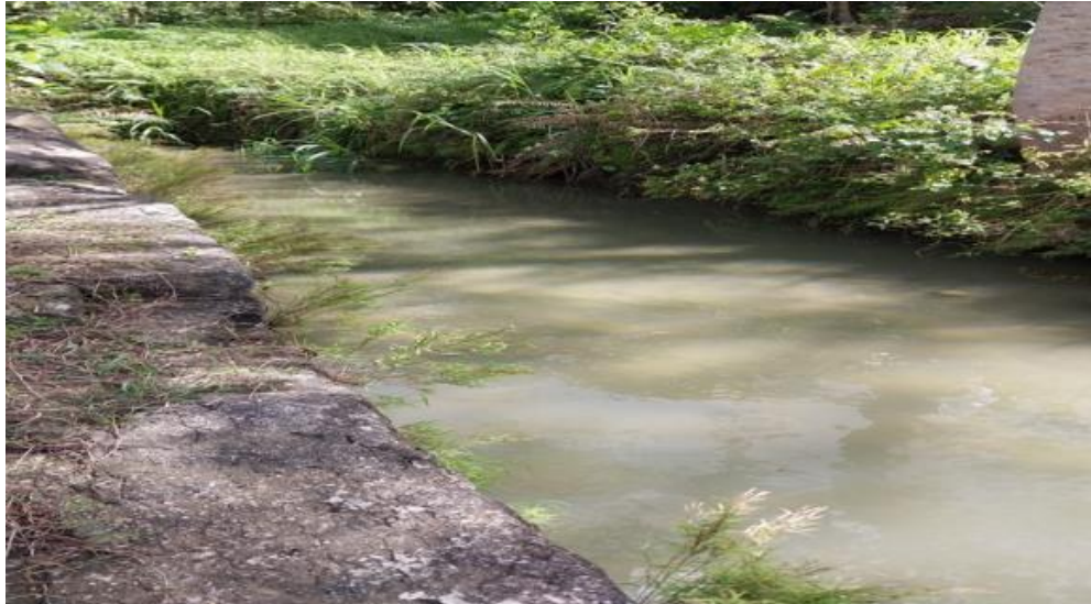
Gambar 7. Kerusakan pada saluran pengeluaran Situ Cidanti
